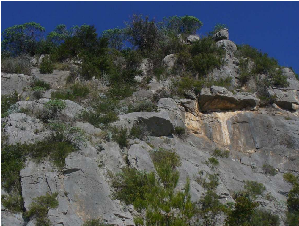
Foto 10. Nicchia di distacco con isolamento a monte di una "mensola" in roccia zona A.
